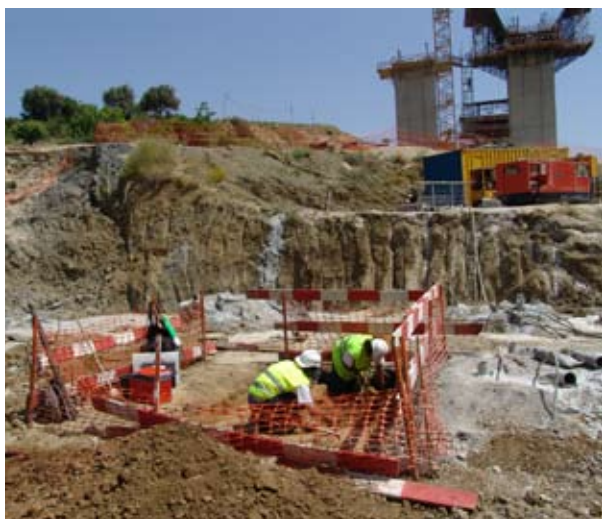
Figura 3 Implantação da área de escavação no terreno e na infraestrutura a construir.
